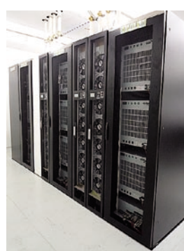
模块型数据中心
