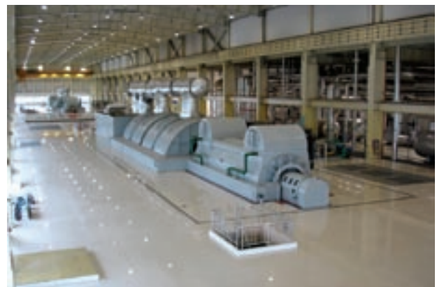
华电国际邹县发电厂四期项目所采用的日立1,000MW超超临界燃煤火力发电设备
