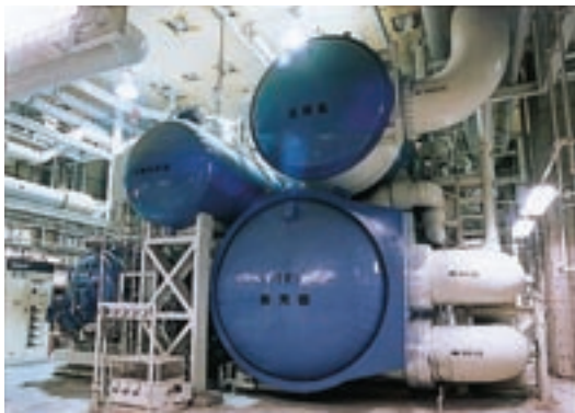
日本新宿区域集中供冷供热中心导入的日立10,000RT级的离心式冷水机
