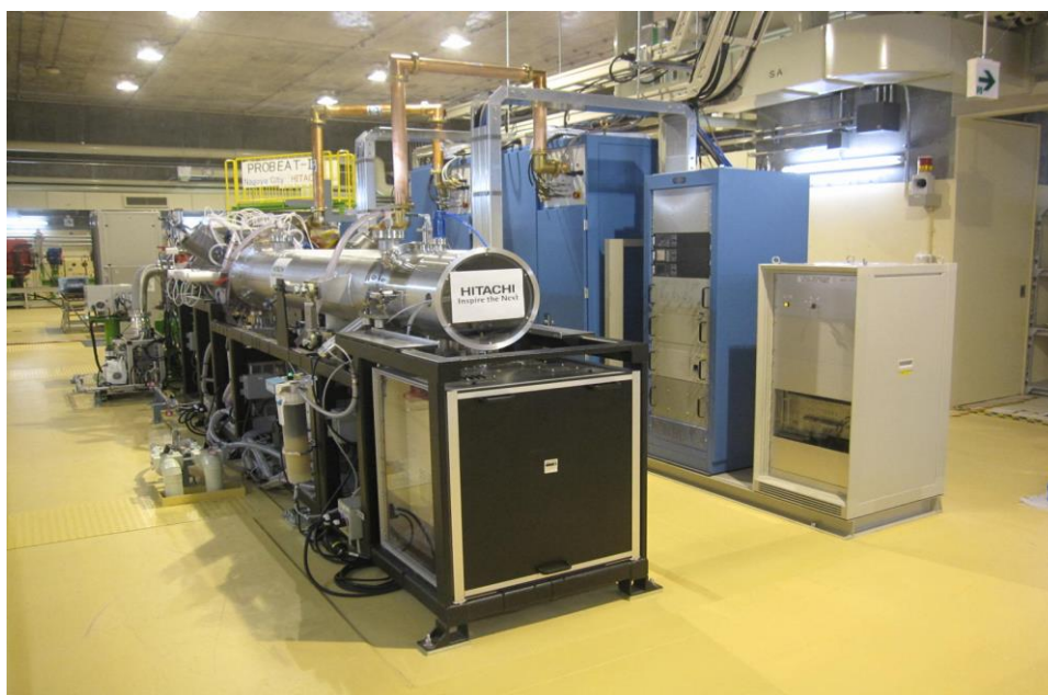
图 3-2 质子注入系统现场图（日本某医院）
